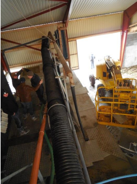
Billede 4: Flow-rør med rør til bassin 1 og 2
